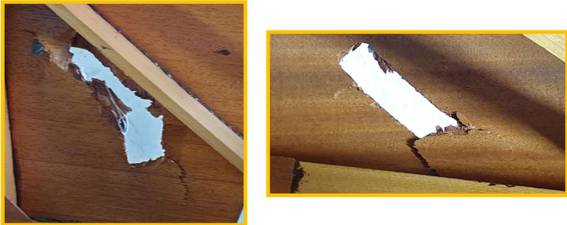
Figure 4 : perforations de la cellule (vues de l'intérieur)
