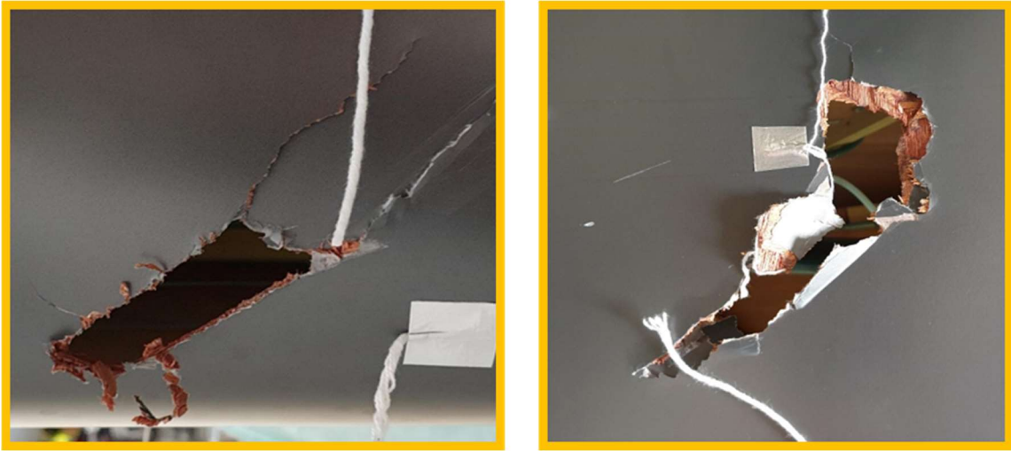
Figure 3 : perforations de la cellule (vues de l'extérieur)
