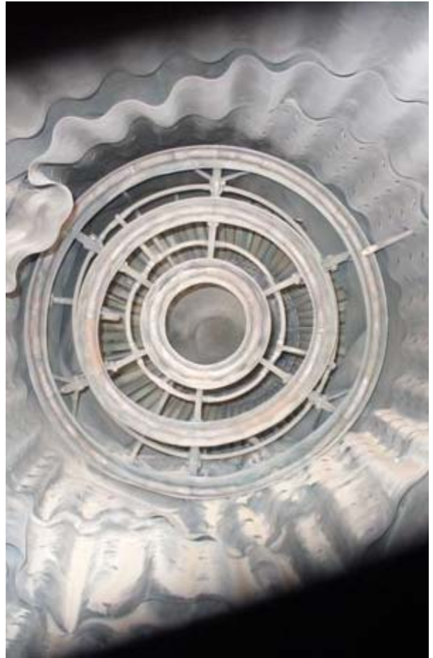
Photo n° 2 : Diffuseur du dernier étage de la turbine
