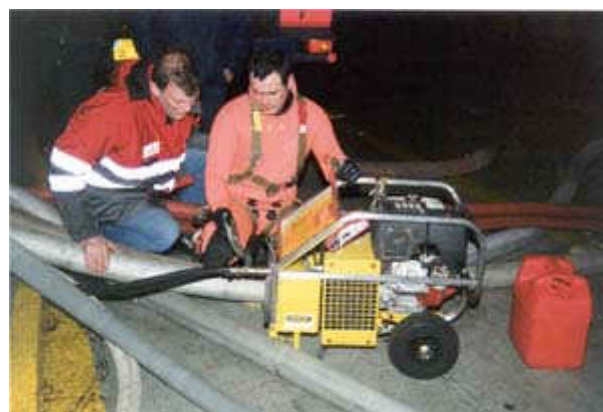
Le MT Pascal Mika installe une pompe à bord du ferry pour évacuer l'eau qui s'engouffre dans le navire. (Photo EV1 Denis Dujardin)
